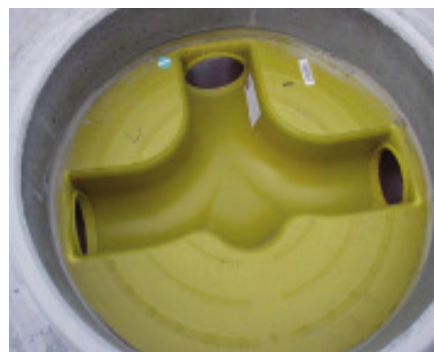
图5 带有塑料管道的人孔小室
