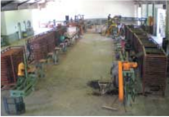
Fig. 1 Fase 1 del módulo PROTILE P45HD para 25.000 placas por shift recientemente instalado en RSA.
