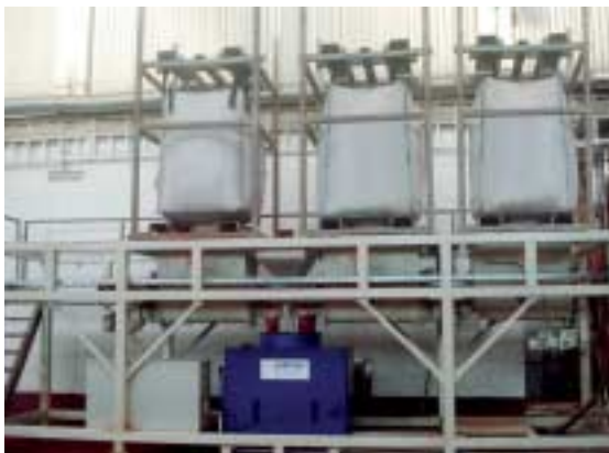
Fig. 7 Instalación neumática de polvo Type FLEX 70, utilizada para colorear placas de techo, en una instalación amasadora de la empresa Kniele en Rumania.
