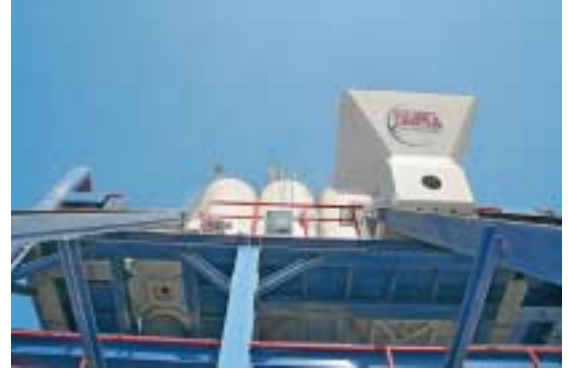
Fig. 5 Los áridos son transportados a la amasadora con cangilones elevadores.
