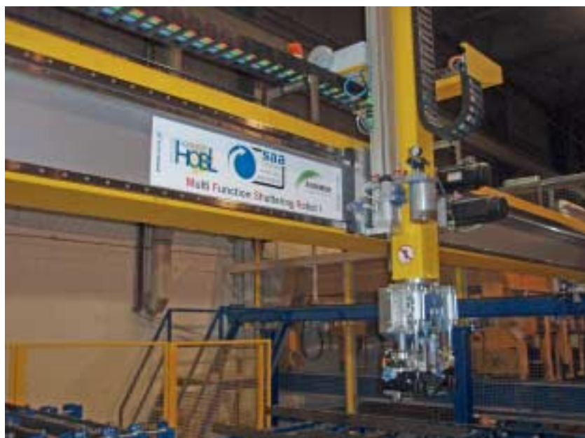
Fig. 1 Robot de encofrado multifunción: eje de z con garras.
