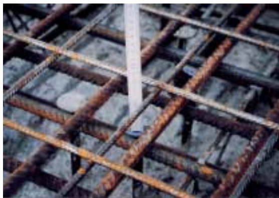
Fig. 2 Anclajes de doble cabeza insertados a una profundidad claramente insuficiente.
