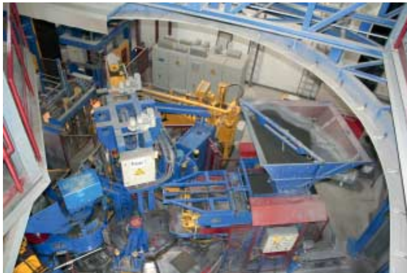
Fig. 5 Las instalaciones de producción incluyen dos prensas de baldosas. La prensa 1 produce continuamente losas de 50 x 50 cm, evitando así la necesidad de cambios.
