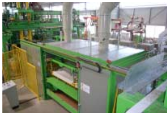
Fig. 4 Sistema Dancing Weigh de KBH instalado.
