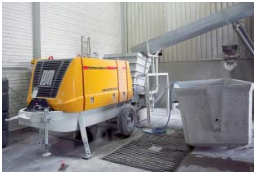
Fig. 3 La bomba de hormigón del tipo BSA 1005 de Putzmeister instalada en la misma nave de producción que la mezcladora de hormigón.
