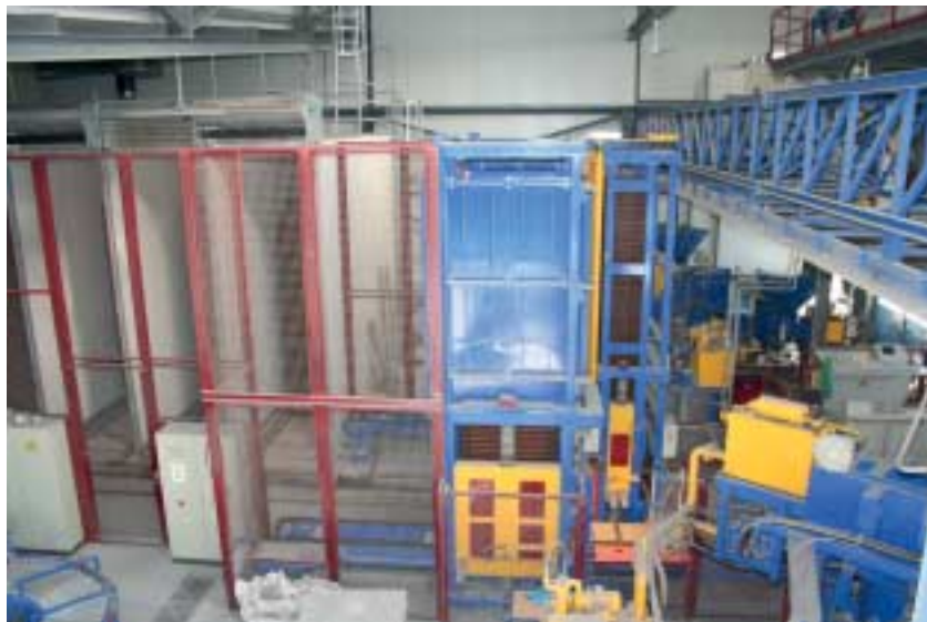
Fig. 9 Las cámaras de curado se han instalado con un sistema de curado al vapor de Kraft Energy.
