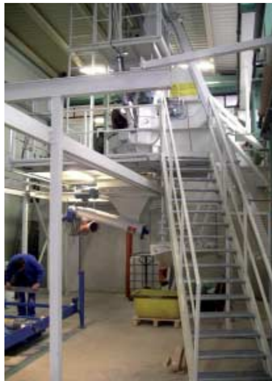
Fig. 2 Vista general de toda la planta de mezclado. Fig. 2 Vista geral da instalação de mistura completa.
