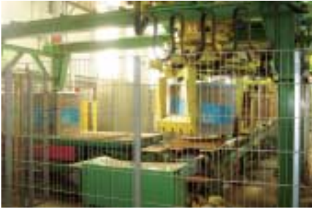
Fig. 6 El apilador de cubos de bloques en dirección a la cinta transportadora.
