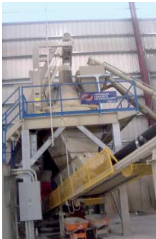
Fig. 1 La planta de mezclado fue diseñada y montada por la empresa Advanced Concrete Technologies, Inc. de Portsmouth (New Hampshire, EEUU).
