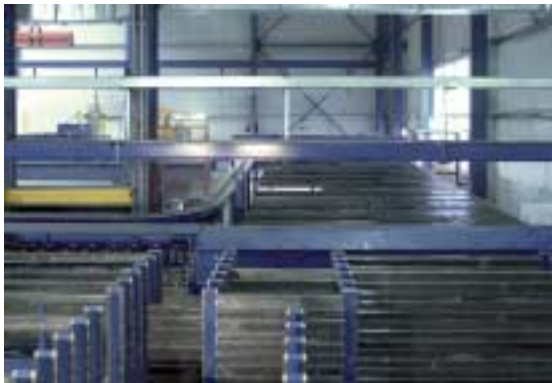
Fig. 6 El depósito activo 1 en la empresa Katzenberger sirve como acumulador adicional de piezas y se incluye en la optimización.
