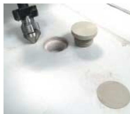
Fig. 5 Agujeros y daños superficiales se taladran. La abertura se rellena entonces con plaquitas y tapones de material plástico, la junta entonces se cierra por soldadura.
