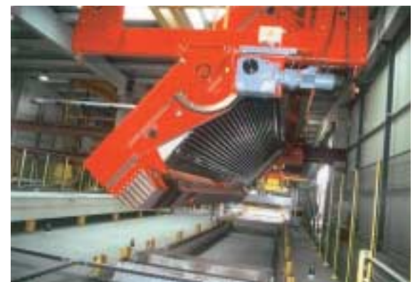
Fig. 5. Retorno del pallet limpiado automáticamente Fig. 5. Retorno das paletas limpas
