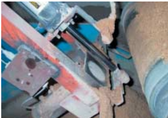
Fig. 6. Los sensores para la medición de áridos con un alto nivel de escayola se limpian automáticamente después de cada dosificación por medio de una pistola de aire comprimido
