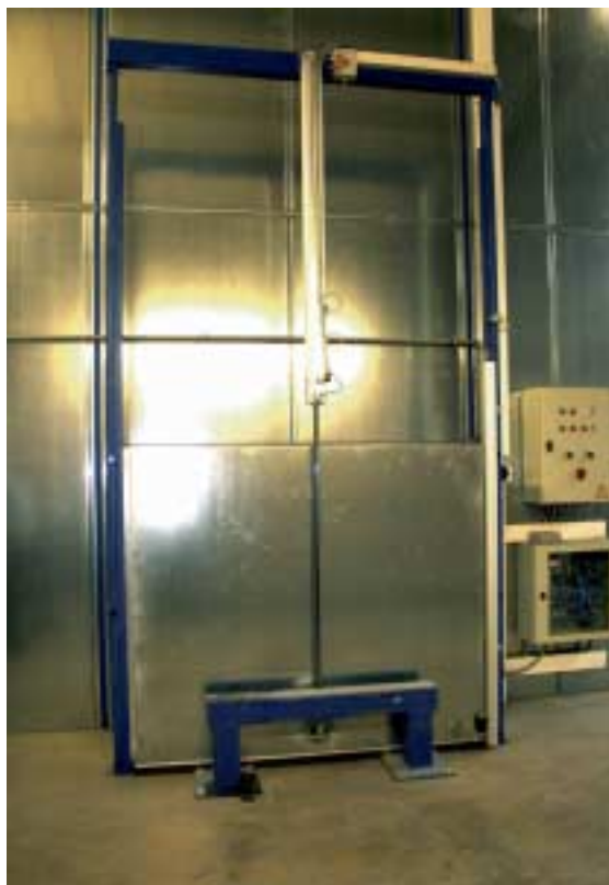
Fig. 5 La cabina de aislamiento acústico está instalada con puertas levadizas controladas automáticamente, que se abren y cierran de modo automático en un extremo para la alimentación de hormigón y, en el otro, para extraer los cubos de bloques producidos.
