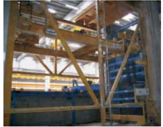
Fig. 5 Almacenaje y desalmacenaje de las paletas en la cámara de fraguado con el transelevador.
