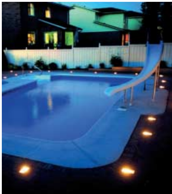
Pavimento iluminado en la piscina Lâmpadas para pavimento da piscina
