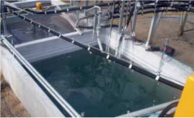
Fig. 6. Balsa con agua clara Imagem 6. Reservatório de água clara
