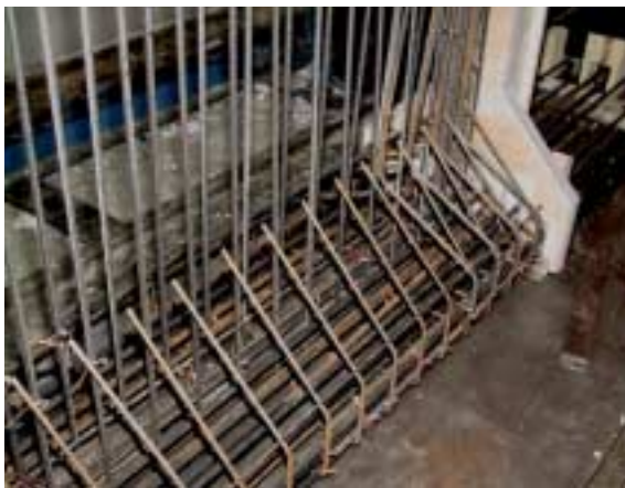
Fig. 4. El armado de alta densidad de una viga pretensada, cómo se muestra en la foto, hace que una compactación adecuada por medio de vibradores sea una tarea demasiado difícil e incluso imposible. La mejor solución es aplicar SCC
