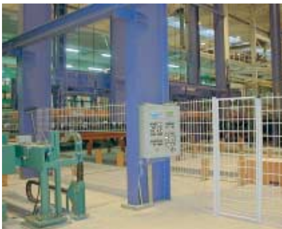
Fig. 2. Instalaciones de seguridad en una instalación de producción
