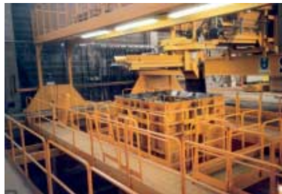
Fig. 11. Instalación de hormigonado transportable con mesa de vibrado estacionaria para elementos con dimensiones 3,5 m x 3,5 m
