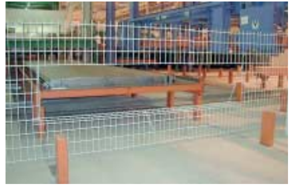
Fig. 4. Valla protectora con apertura y acceso difícil
