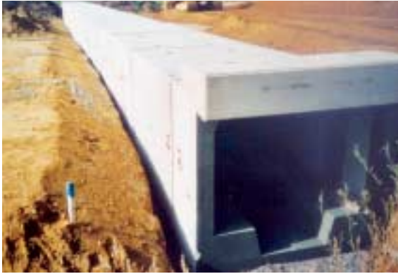
Fig. 12. Desviación Halle este. Pasaje de carretera 2,0 m x 1,75 m con sección transversal especial para anfibios. L = 60 m
