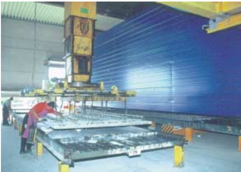
La planta trasladada y ampliada actualmente en Fellbach-Schmiden A instalação que foi transposta e ampliada em Fellbach-Schmiden
