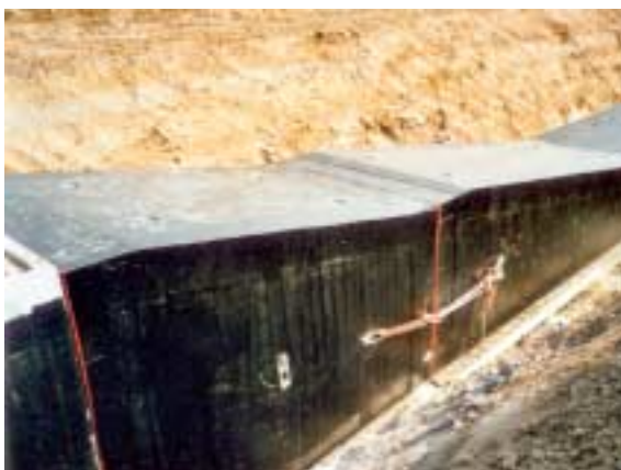
Fig. 13. BMW – Leipzig. Paso bajo la vía de ferrocarril con secciones transversales variables de 2,75 m x 3,0 m a 2,75 m x 1,0 m (dimensiones internas). Longitud total 100 m. La sección a profundidad del cruce bajo la vía tiene un área transversal de 2,75 m x 1,00 m y una longitud de 60,0 m
