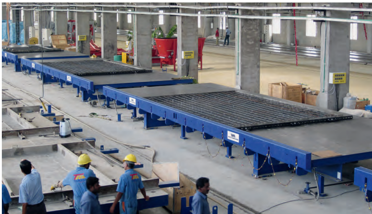
В настоящее время для производства стеновых элементов имеются в распоряжении четыре опрокидывающих стола с регулируемой по краям стальной опалубкой.
