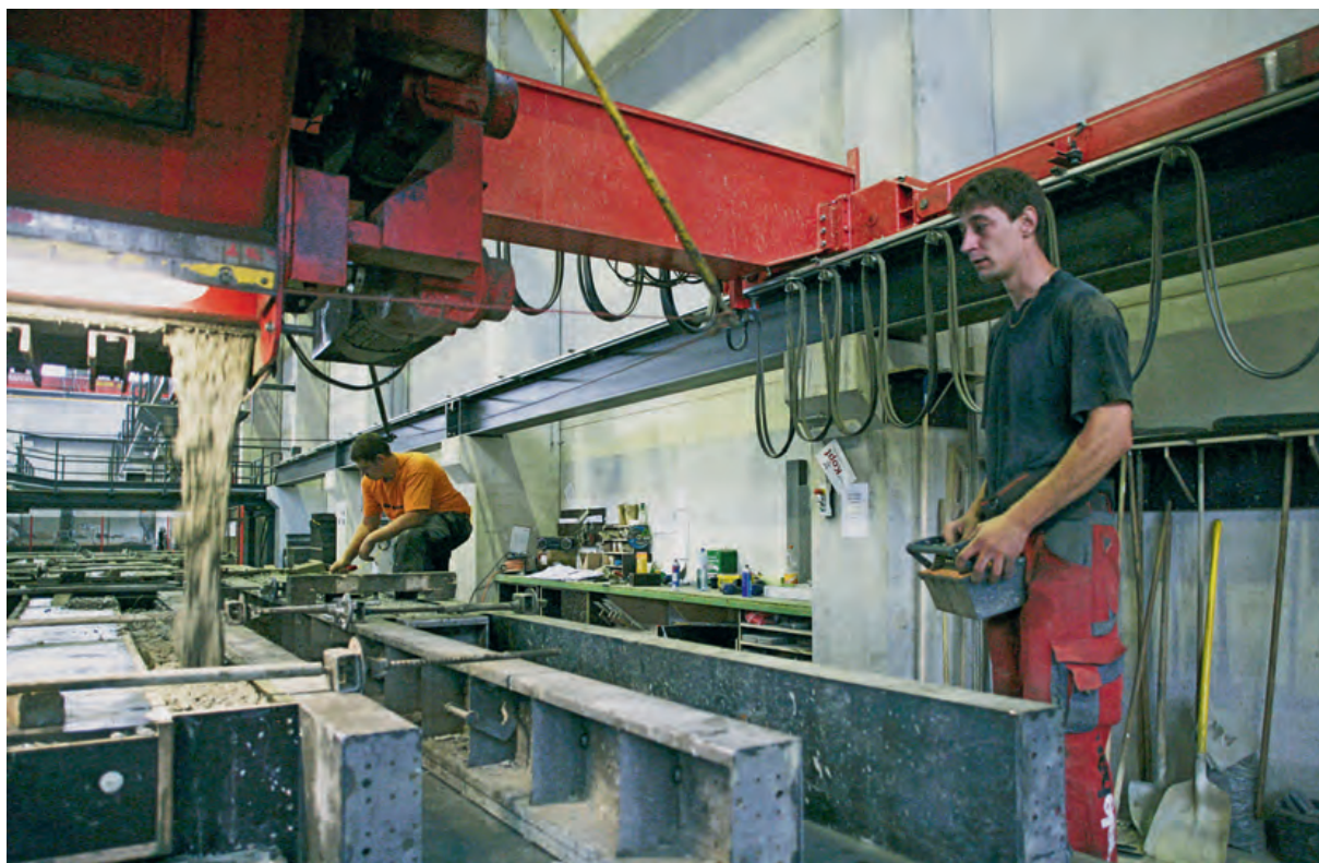
Подача бетона осуществляется через наполняемую поворотную ёмкость, которая управляется с помощью мобильного блока управления стоящим рядом квалифицированным рабочим.
