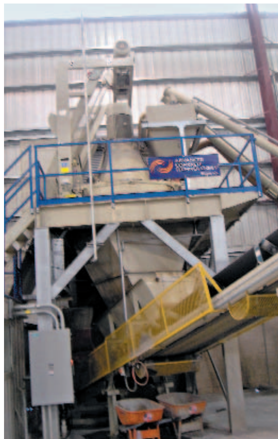
Рис. 1 Смесительная установка спроектирована и поставлена компанией Advanced Concrete Technologies, Inc. из Портсмута (Нью Гемпшир, США)
