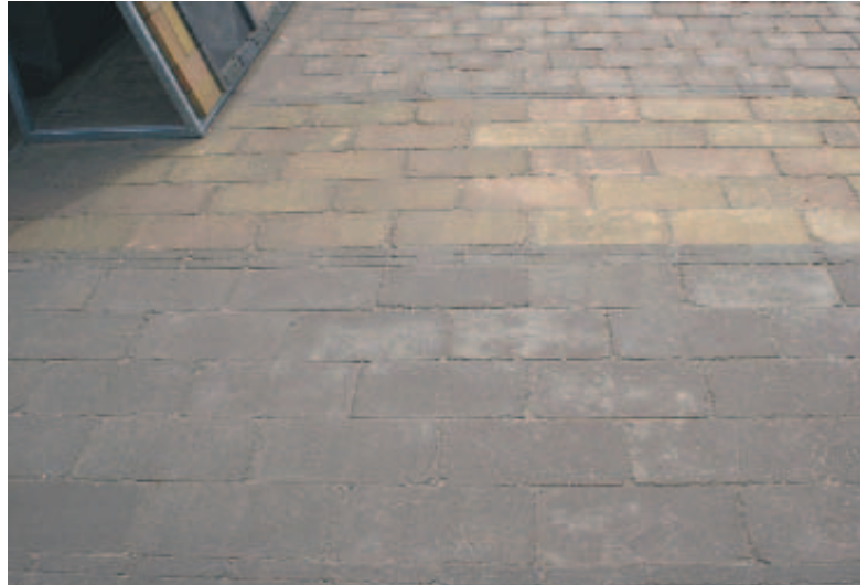
Рис. 9 Отличия между блоками на участке, где уложены образцы, заметны даже через год эксплуатации.
