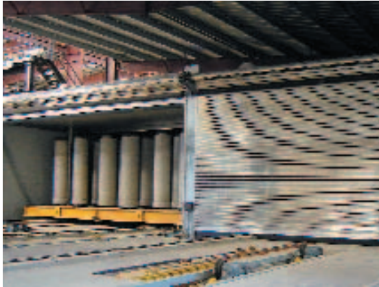
Рис. 6 Сушильная камера включает в себя систему обогрева разработки Kraft Energy Systems, Inc.
