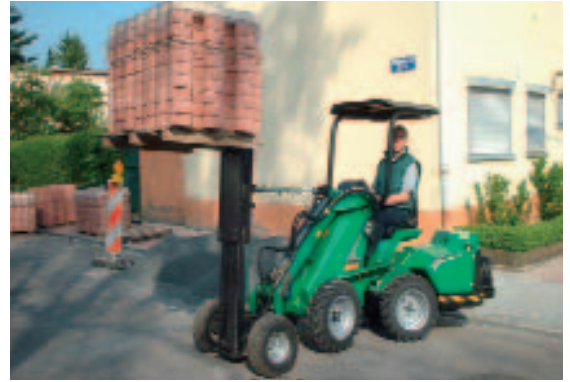
Рис.6 Малогабаритные погрузчики с шарнирной рамой производства Avant, которые весят всего 500 кг, без труда справляются с 1,5-тонным поддоном с плиткой, транспортируя его на штабелере, опирающемся на колесное шасси.
