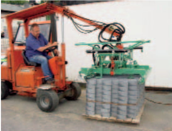
Рис.2 Hunklinger разработала легкий захват для укладки брусчатки Pflastergreif Type 02 с одноконтурной системой управления для применения на существующих машинах-укладчиках. На фото захват установлен на машине производства Goesken.
