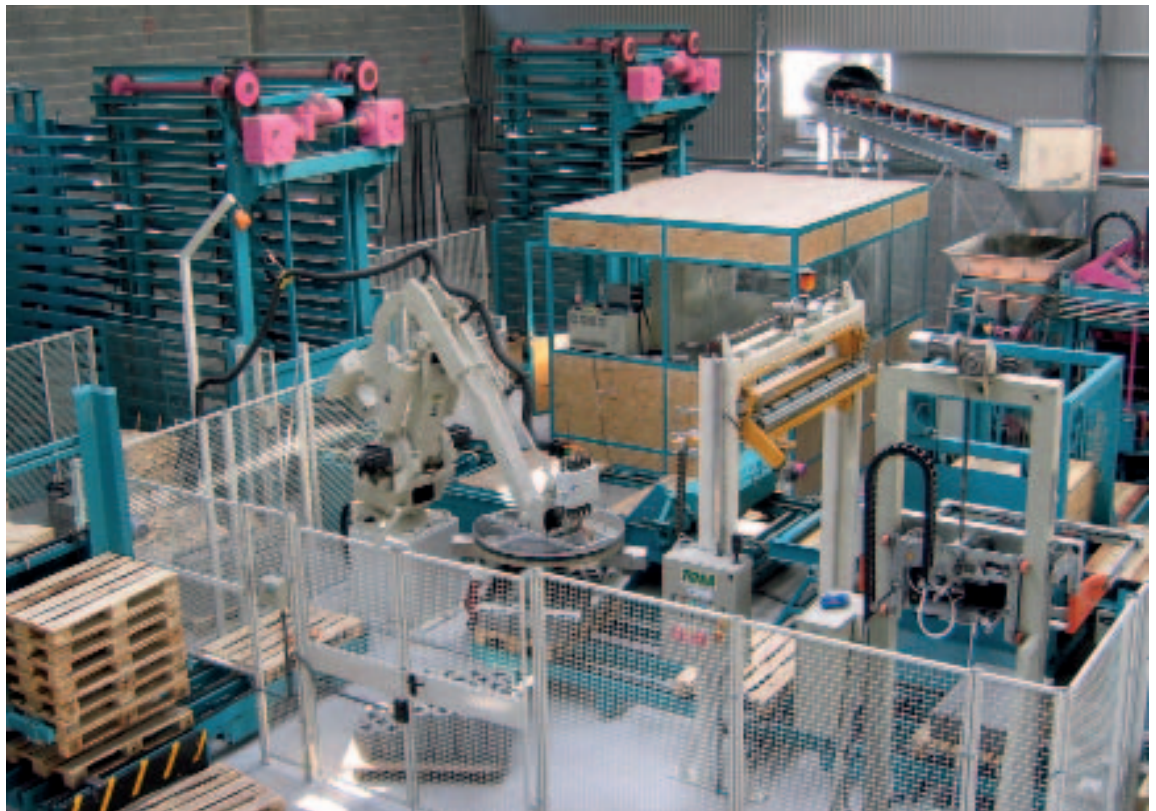
Рис. 1 Гибкая роботизированная установка для штабелирования с серво-грейферным механизмом (захватами) на заводе бетонных изделий.
