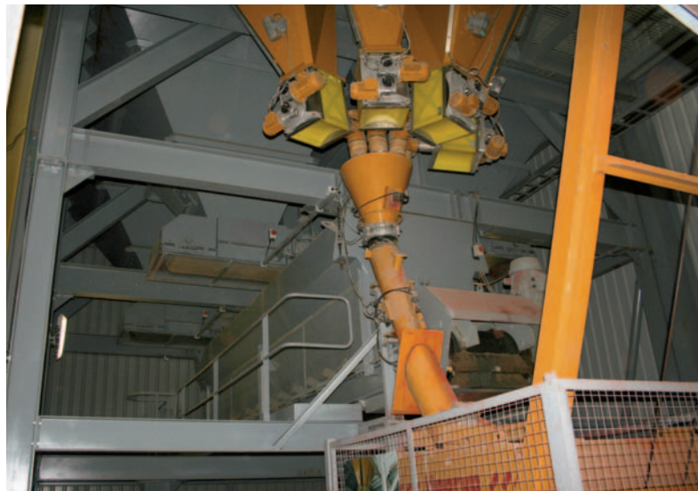
Рис. 1 Скиповые подъемники с узлами подачи.
