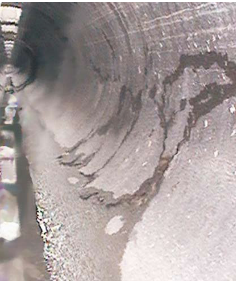
▲ FIG. 2 Longitudinal and shear cracks inside the gutter. // ABB. 2 Längs- und Scherrisse im Rinneninnern.
