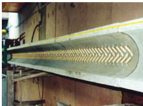
► FIG. 1 Structured area of a 25 m long, tested concrete drainage channel (DN 400) [4]. // ABB. 1 Strukturierter Bereich einer 25 m langen Betonrohrversuchsstrecke DN 400 [4].
