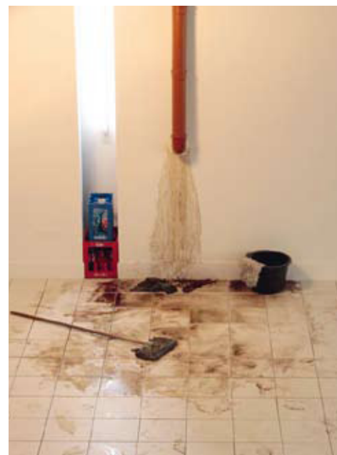
▲ FIG. 2 Leakage due to inappropriate sealing using “well foam” // ABB. 2 Undichtigkeit durch nicht fachgerechte Abdichtung mit „Brunnenschaum“.
