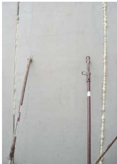
► FIG. 1 Bilateral longitudinal crack above the lattice girder // ABB. 1 Beidseitiger Längsriss über Gitterträger.
