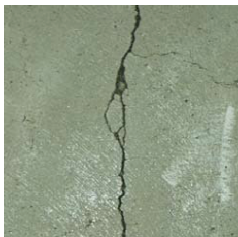
▲ FIG. 1 Fracturing of a crack edge on the surface of an industrial floor subjected to vehicle traffic. // ABB. 1 Rissflankenbruch an der Oberfläche eines befahrenen Industriefußbodens.
